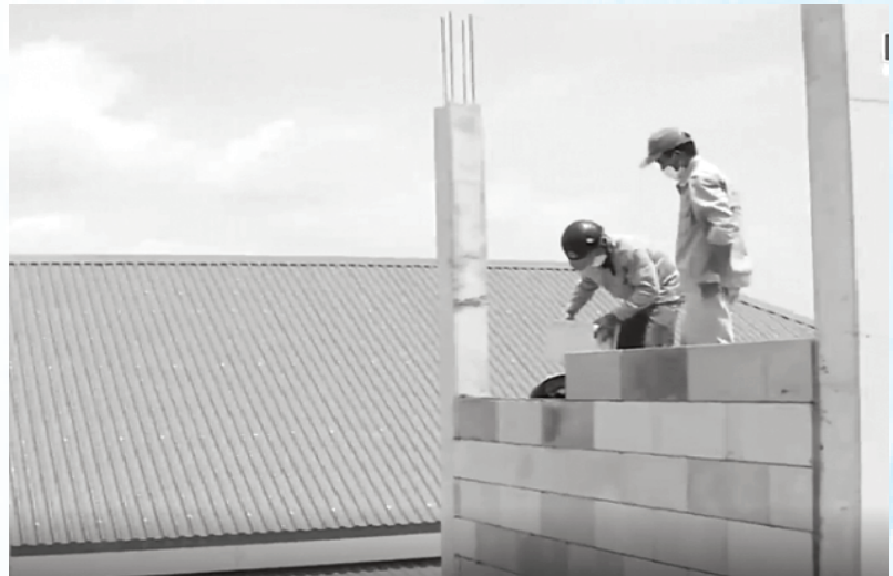
Công trình nhà ở của chị Trần Thị Nguyệt, xã Thạch Hưng đang được lắp ghép hoàn toàn bằng loại gạch không nung lõi xốp; ảnh: PV
