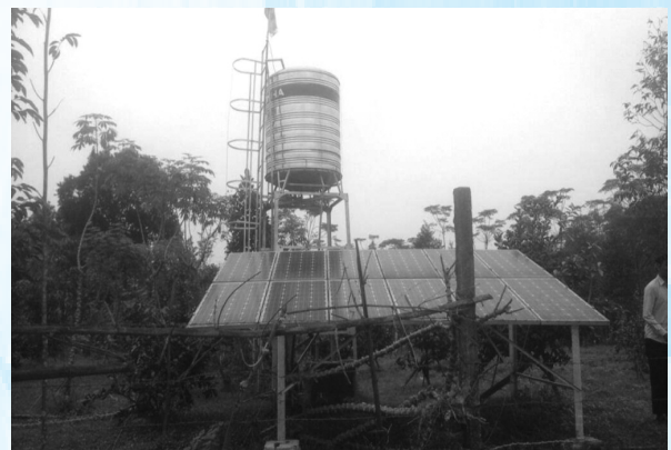
Hệ thống bơm điện mặt trời tưới bưởi công suất 1,5 KW.
