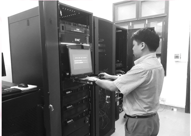
Trung tâm dữ liệu, điều hành mạng và máy chủ của BHXH tỉnh Hà Tĩnh
