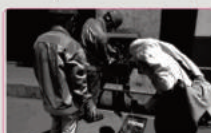
Kiểm định, đo tiếp địa an toàn chống sét
